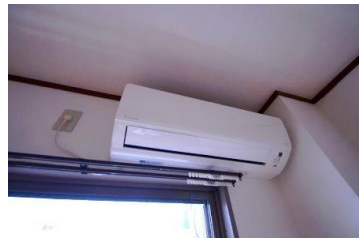
エアコン1台設備
